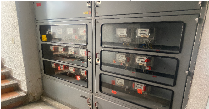
Contador de Energia
