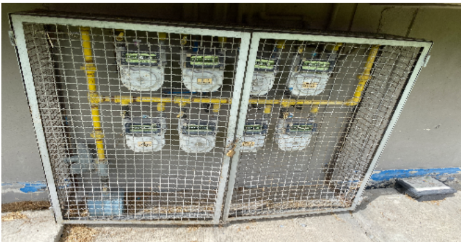
Contador de Gas
