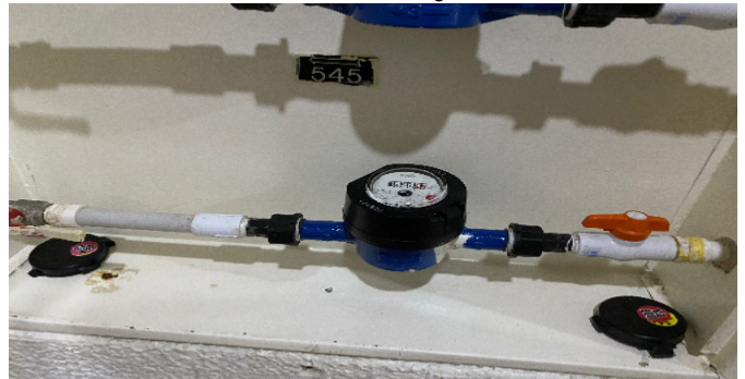
Contador de Agua
