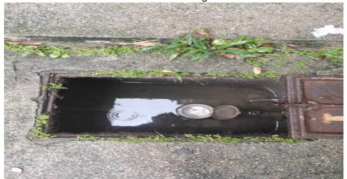
Contador de Agua
