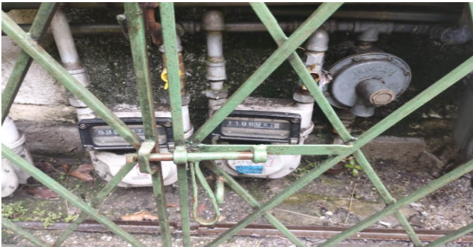
Contador de Gas
