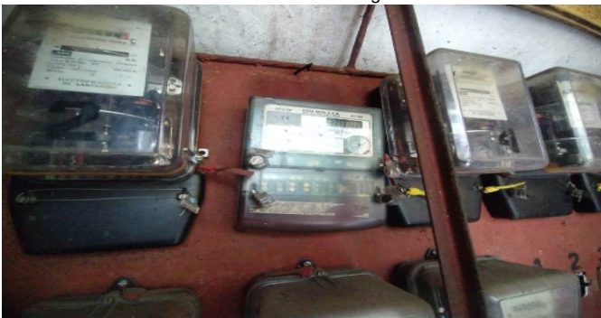
Contador de Energia
