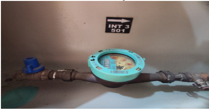
Contador de Agua
