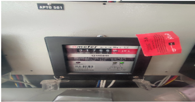
Contador de Energia
