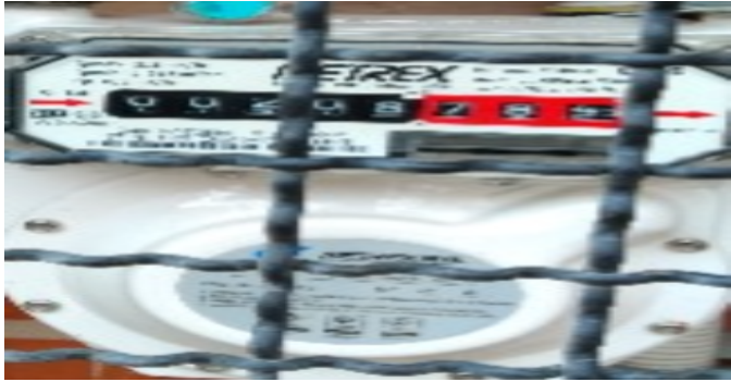
Contador de Gas
