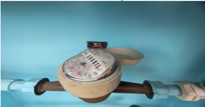
Contador de Agua
