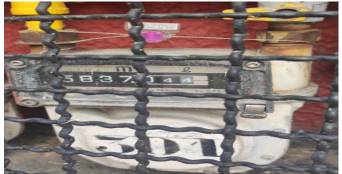
Contador de Gas
