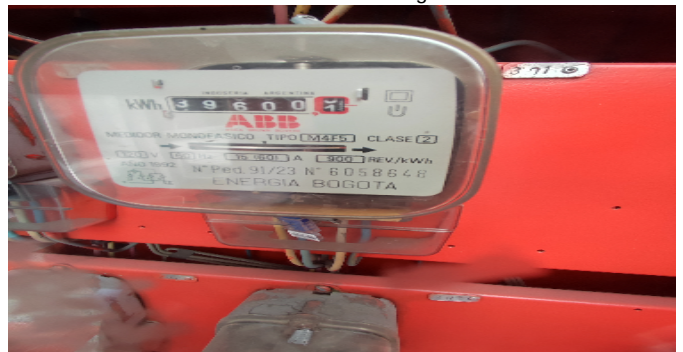
Contador de Energia
