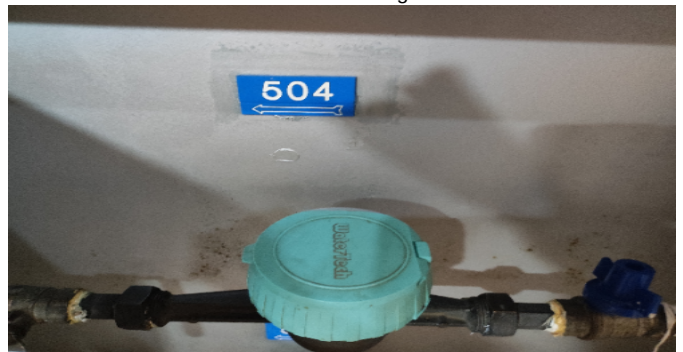
Contador de Agua
