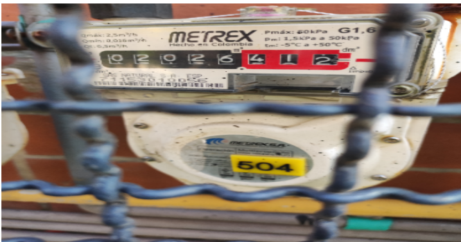
Contador de Gas
