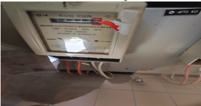
Contador de Energia
