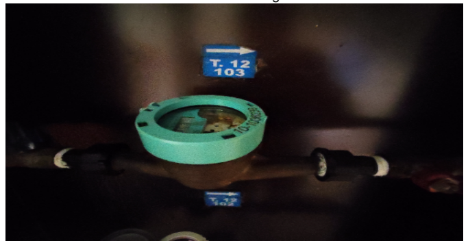
Contador de Agua
