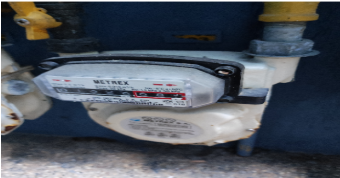
Contador de Gas
