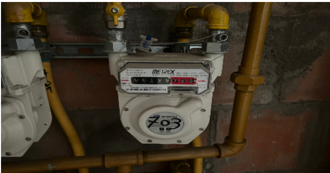
Contador de Gas
