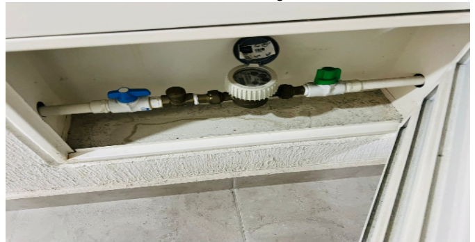
Contador de Agua
