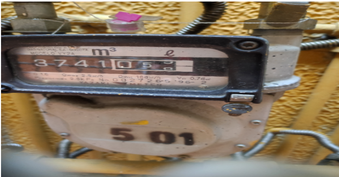
Contador de Gas
