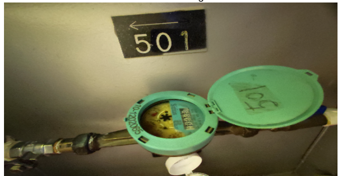
Contador de Agua
