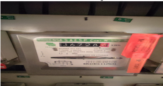
Contador de Energia
