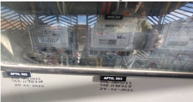
Contador de Energia
