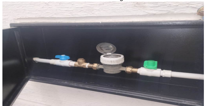
Contador de Agua
