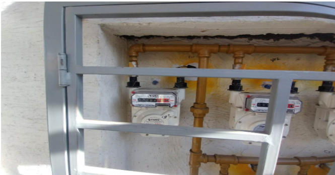
Contador de Gas
