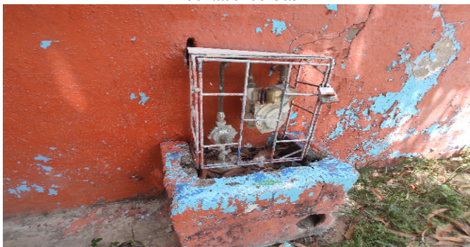
Contador de Gas
