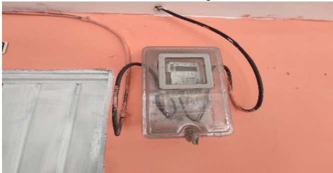
Contador de Energia
