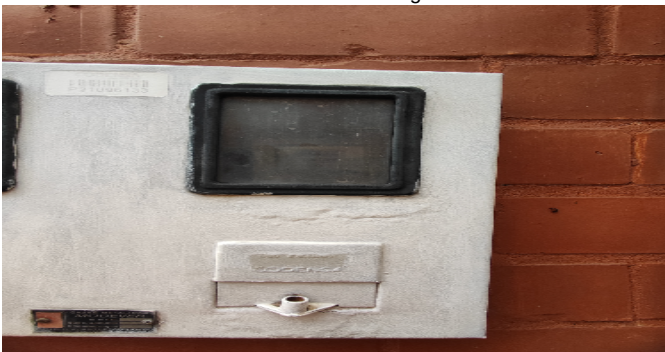
Contador de Energia
