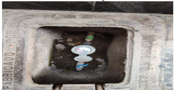
Contador de Agua
