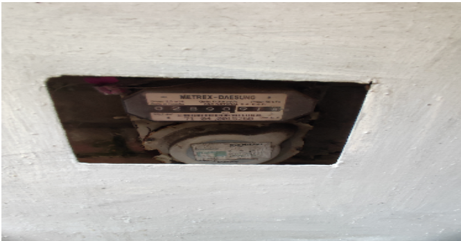
Contador de Gas
