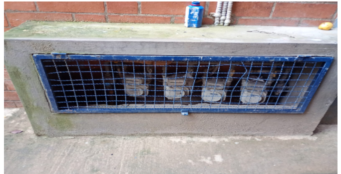
Contador de Gas
