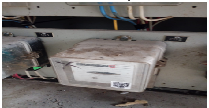
Contador de Energia
