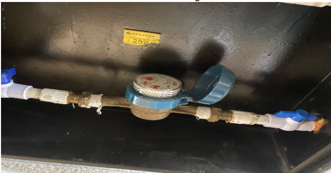
Contador de Agua
