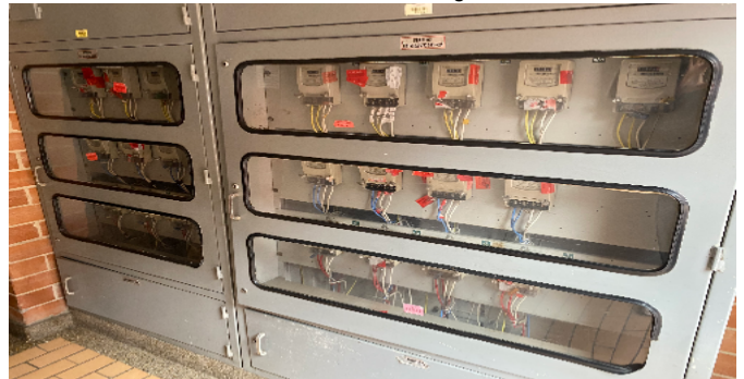
Contador de Energia
