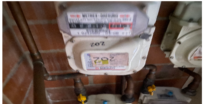
Contador de Gas
