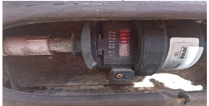
Contador de Agua
