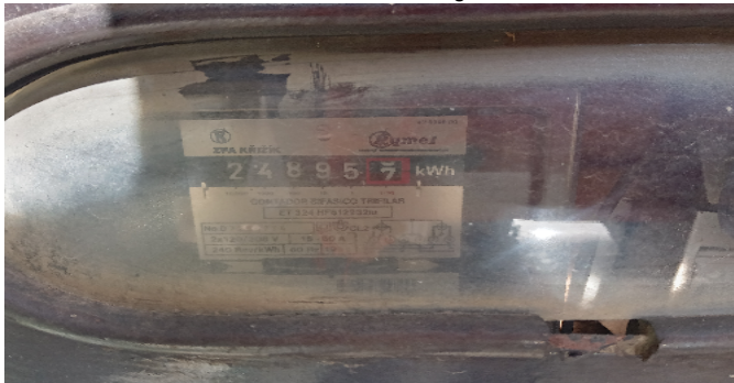
Contador de Energia
