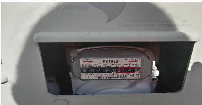
Contador de Gas
