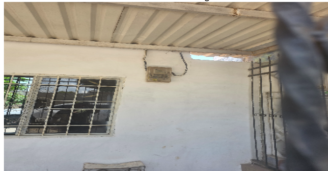
Contador de Energia
