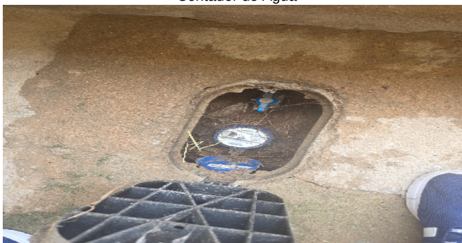
Contador de Agua
