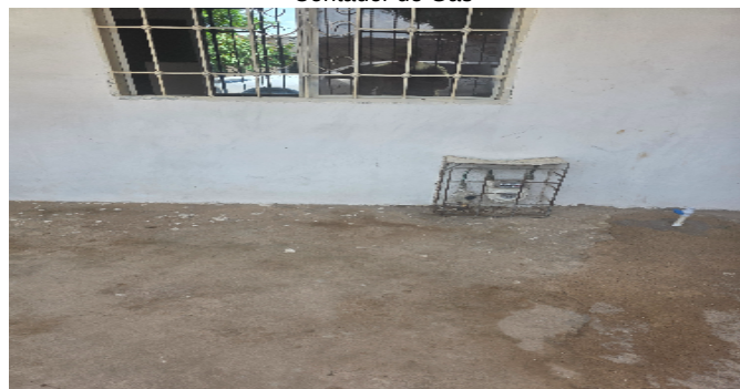
Contador de Gas
