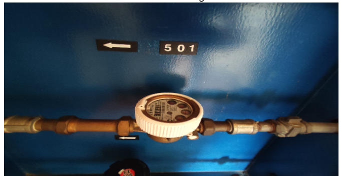
Contador de Agua
