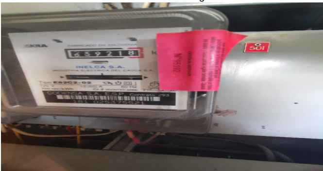
Contador de Energia
