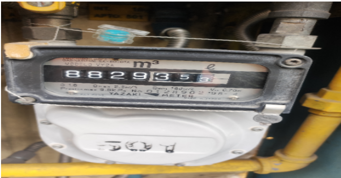
Contador de Gas
