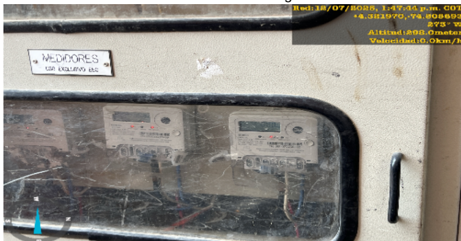
Contador de Energia
