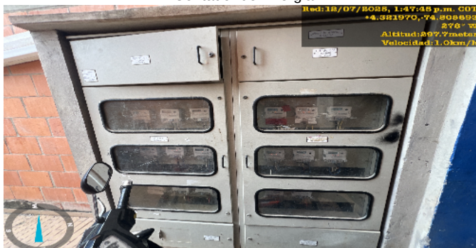
Contador de Energia
