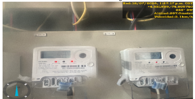
Contador de Energia
