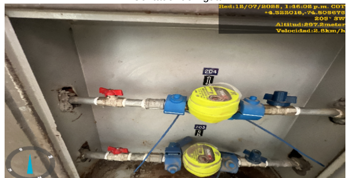
Contador de Agua
