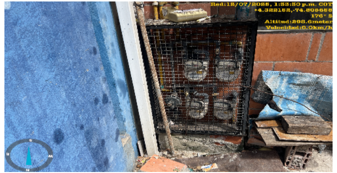
Contador de Gas
