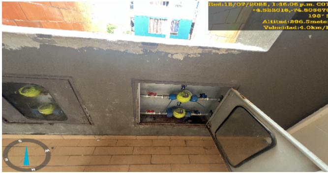
Contador de Agua
