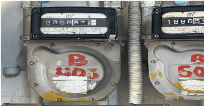
Contador de Gas
