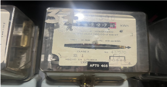
Contador de Energia
