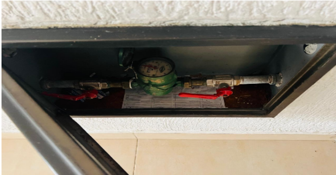
Contador de Agua
