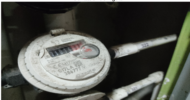
Contador de Agua
