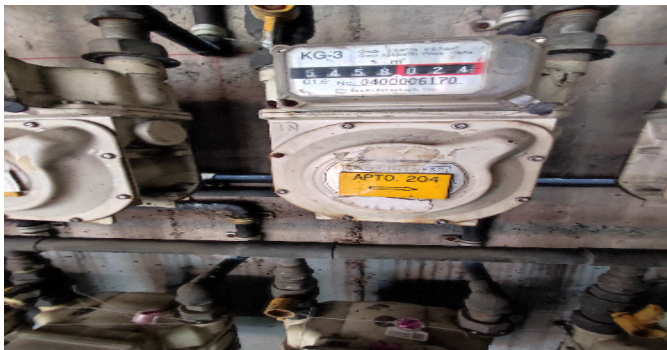
Contador de Gas
