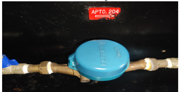
Contador de Agua
