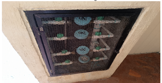
Contador de Agua
