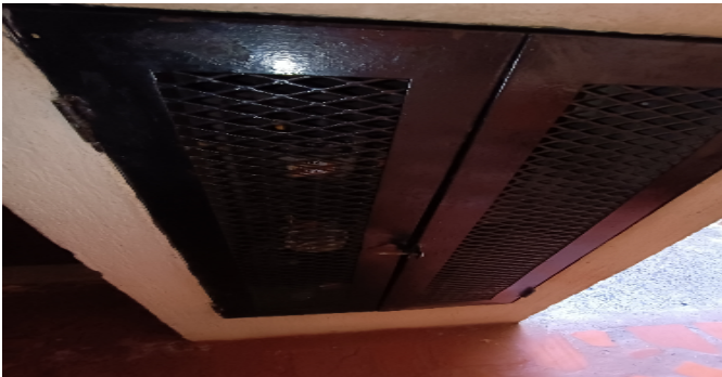
Contador de Gas
