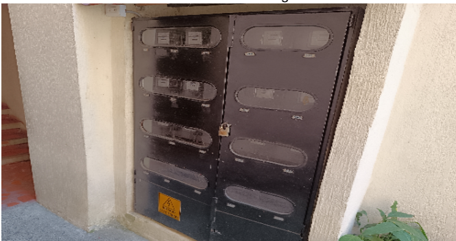
Contador de Energia
