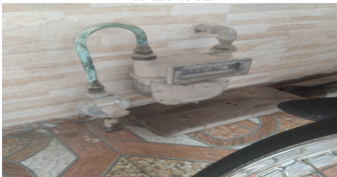
Contador de Gas
