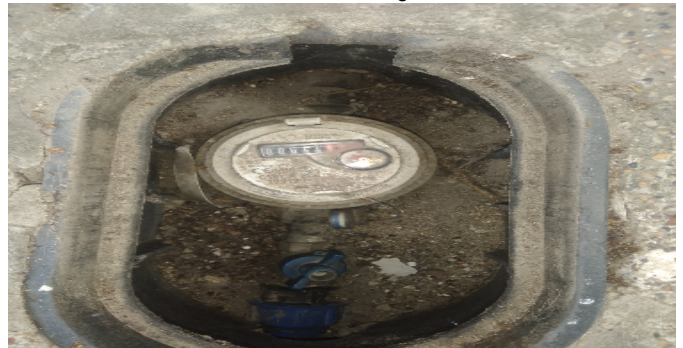
Contador de Agua
