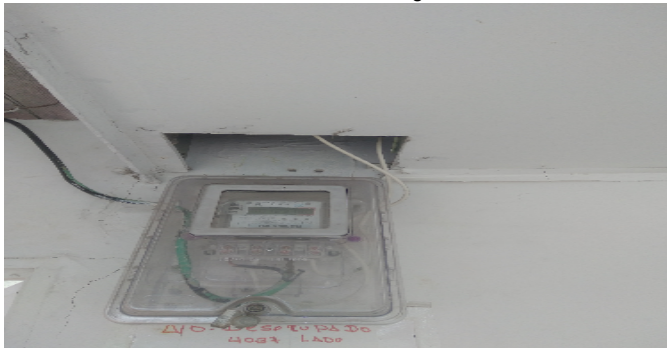
Contador de Energia
