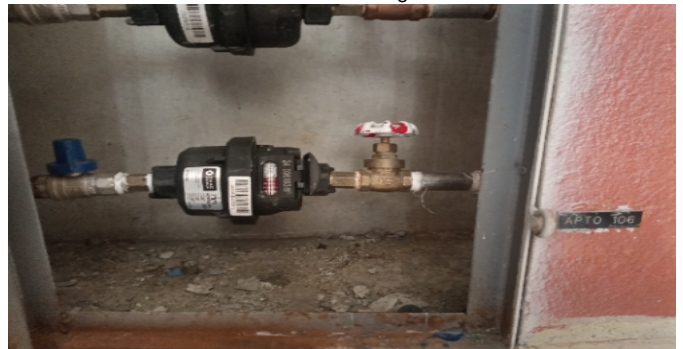
Contador de Agua
