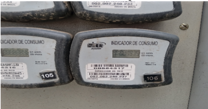
Contador de Energia
