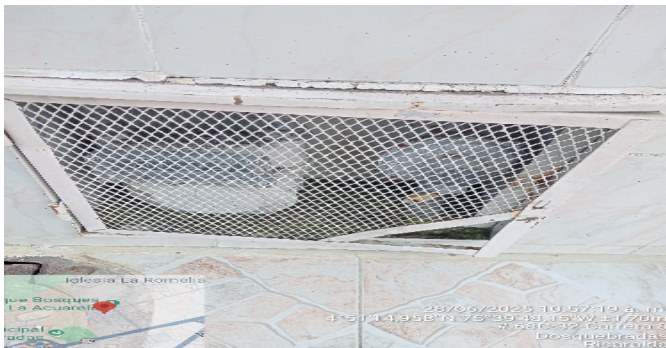
Contador de Gas
