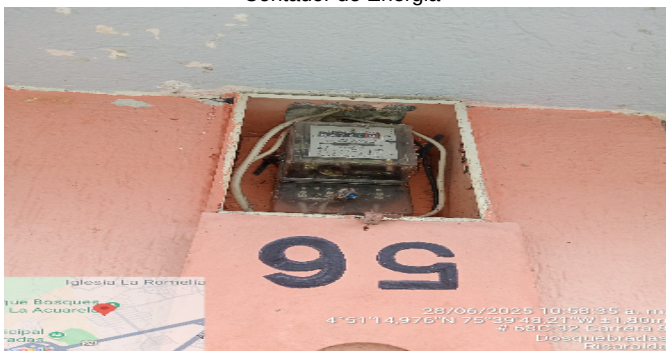
Contador de Energia
