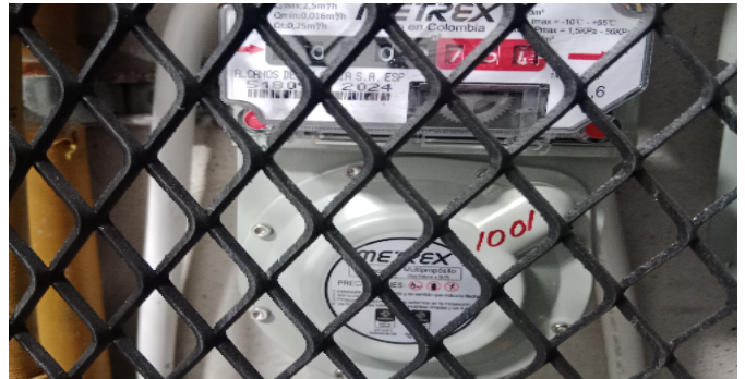
Contador de Gas
