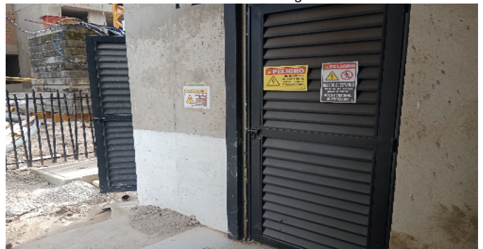
Contador de Energia
