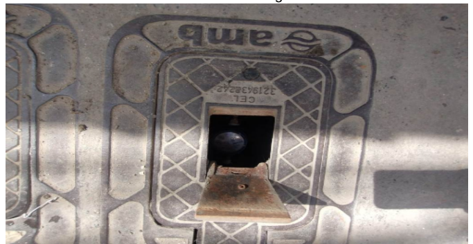
Contador de Agua
