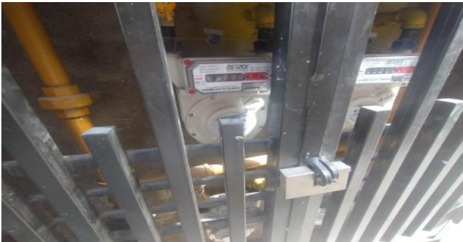
Contador de Gas
