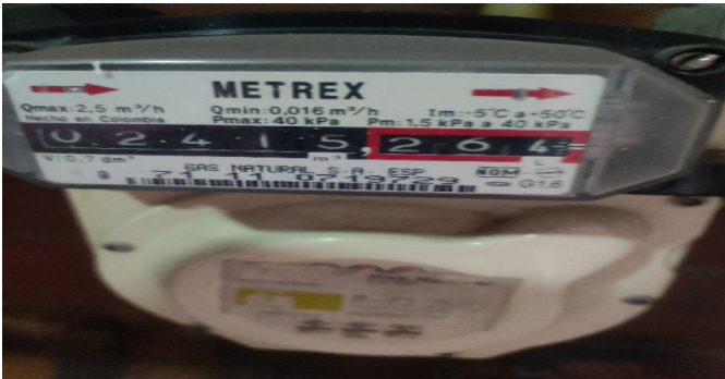
Contador de Gas
