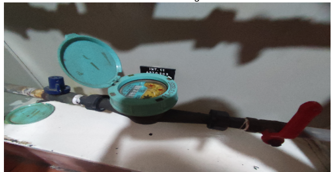
Contador de Agua
