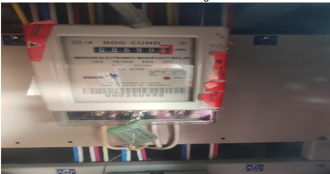
Contador de Energia
