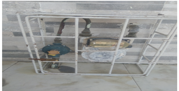
Contador de Gas
