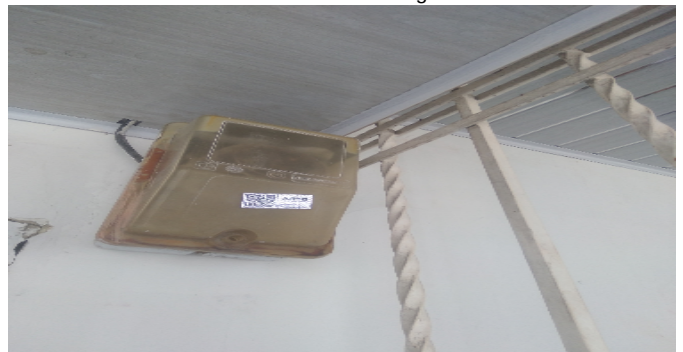
Contador de Energia
