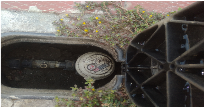
Contador de Agua
