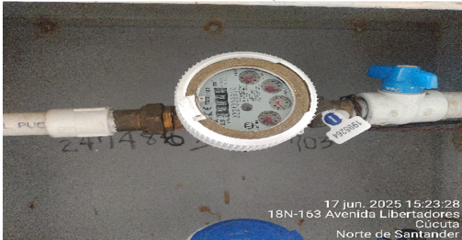
Contador de Agua
