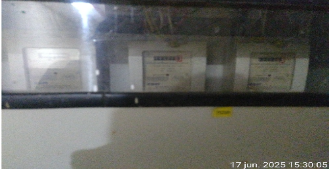
Contador de Energia
