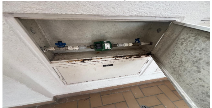
Contador de Agua
