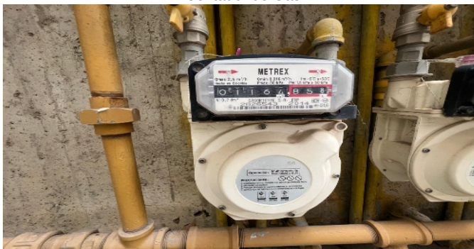
Contador de Gas
