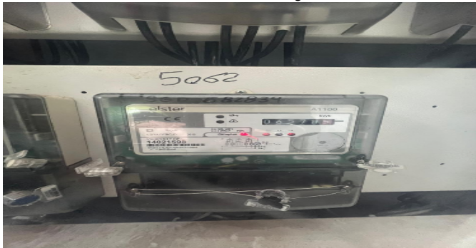
Contador de Energia
