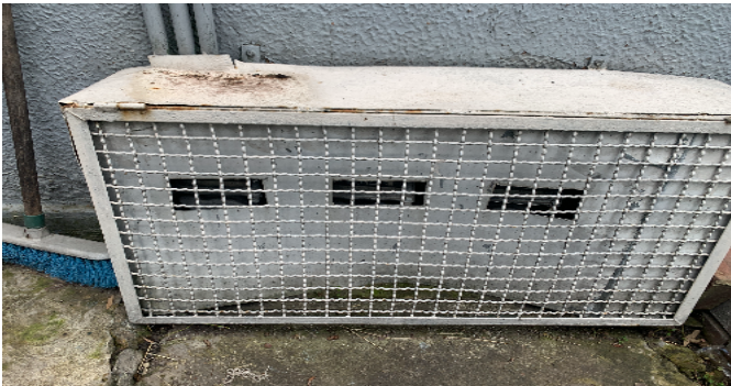
Contador de Gas
