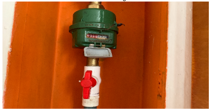
Contador de Agua
