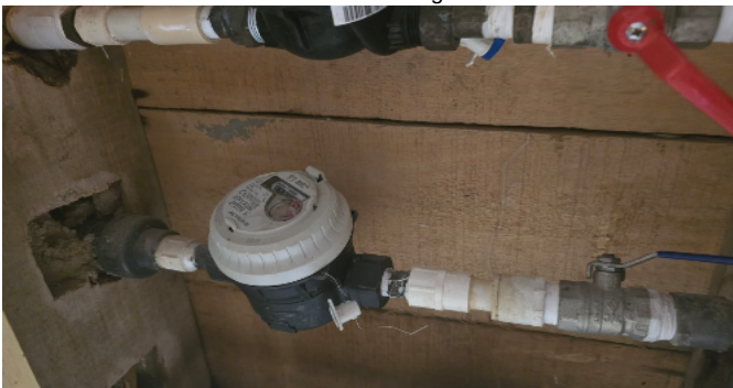
Contador de Agua
