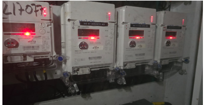
Contador de Energia
