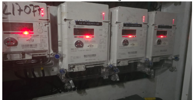
Contador de Energia
