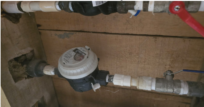
Contador de Agua
