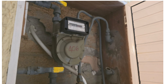
Contador de Gas
