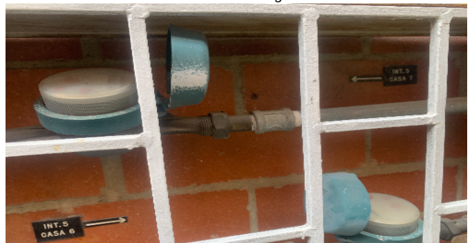
Contador de Agua
