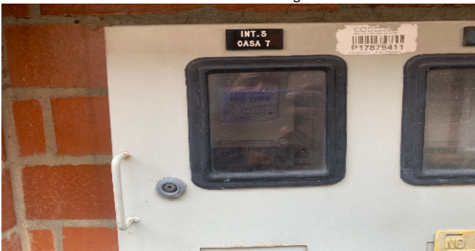
Contador de Energia
