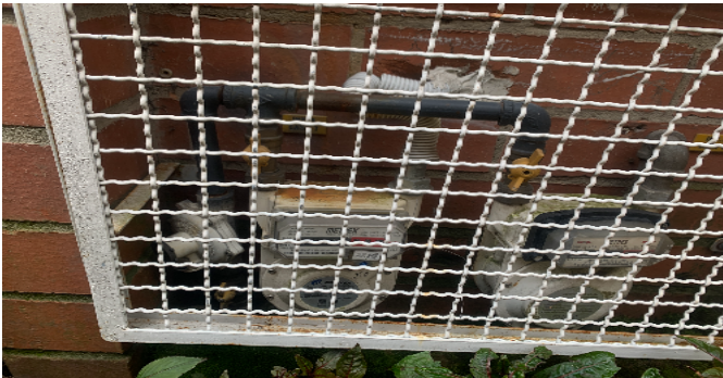
Contador de Gas
