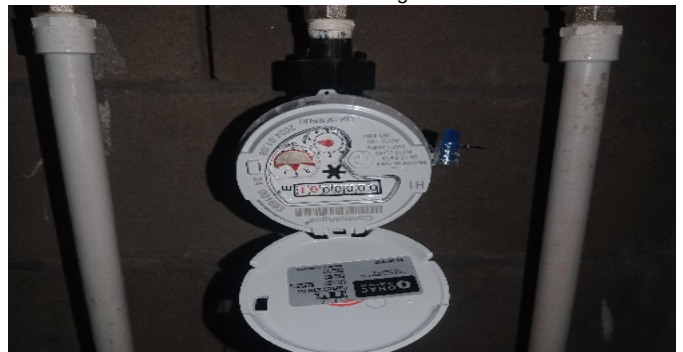
Contador de Agua
