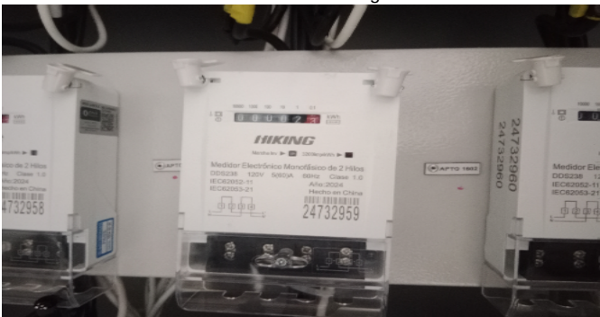
Contador de Energia
