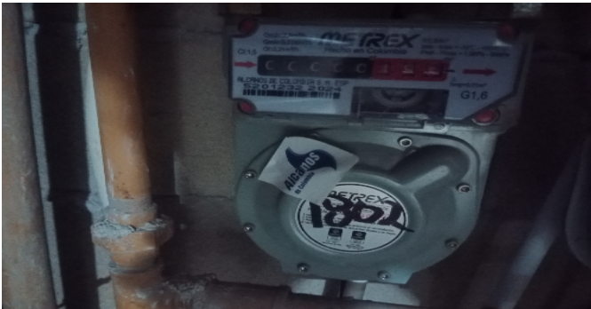
Contador de Gas
