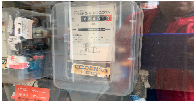
Contador de Energia
