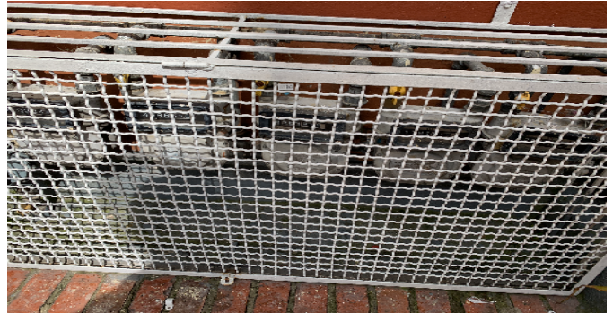
Contador de Gas
