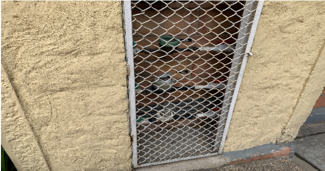
Contador de Agua
