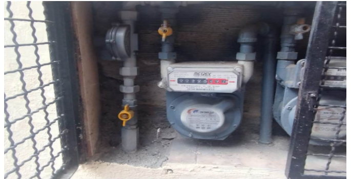
Contador de Gas
