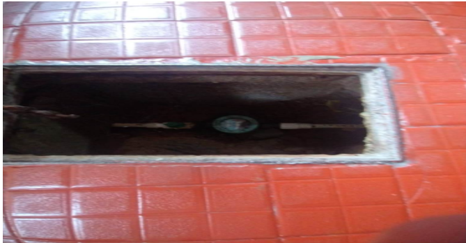
Contador de Agua
