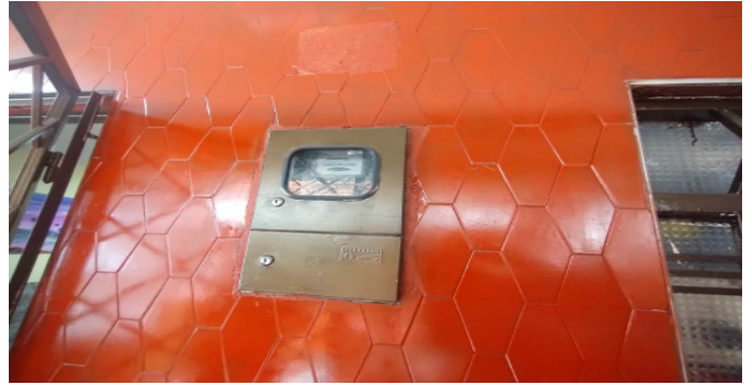
Contador de Energia
