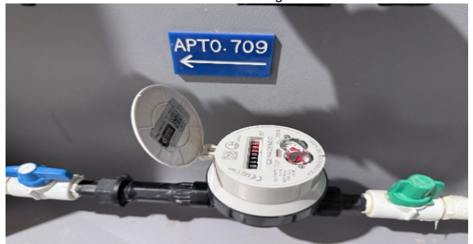
Contador de Agua
