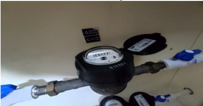
Contador de Agua
