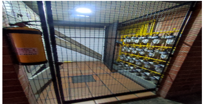
Contador de Gas
