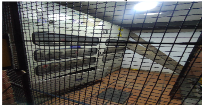
Contador de Energia
