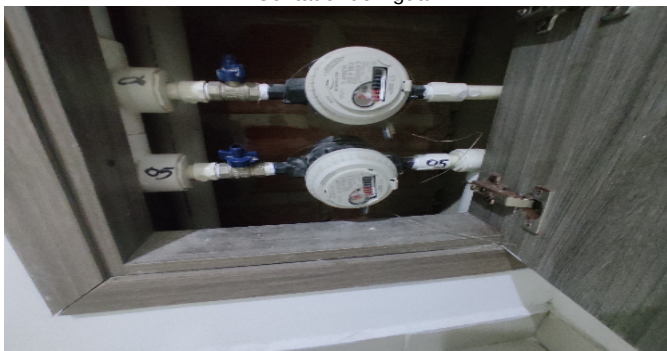
Contador de Agua
