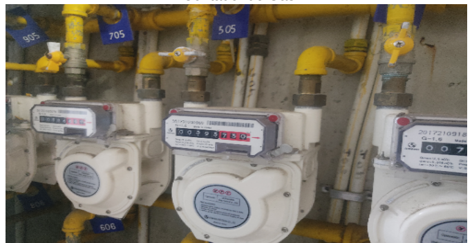
Contador de Gas
