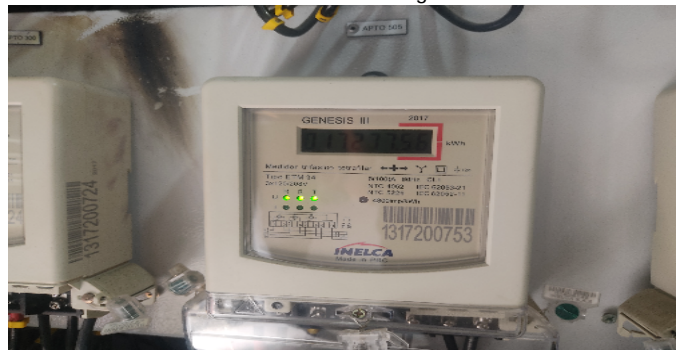
Contador de Energia
