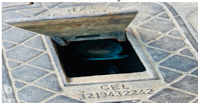
Contador de Agua
