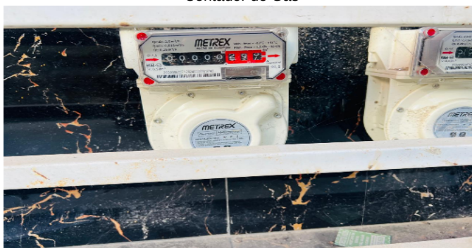
Contador de Gas
