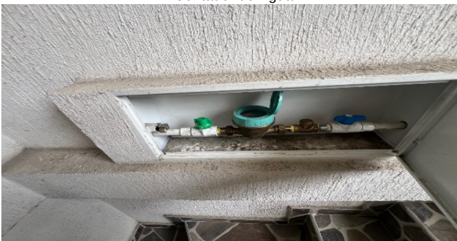
Contador de Agua
