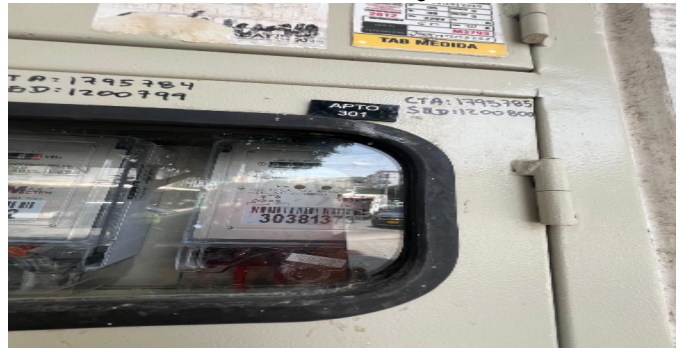
Contador de Energia
