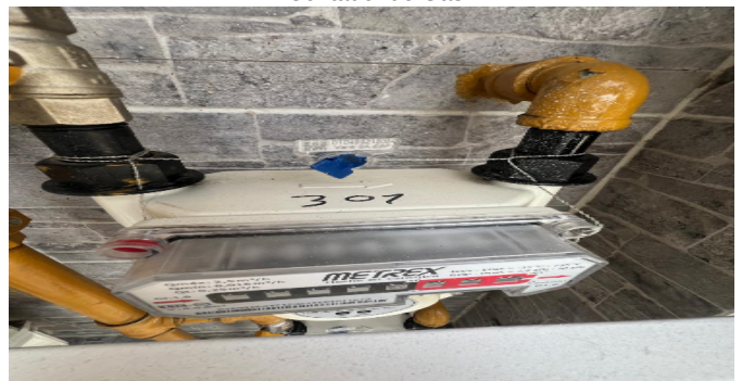
Contador de Gas
