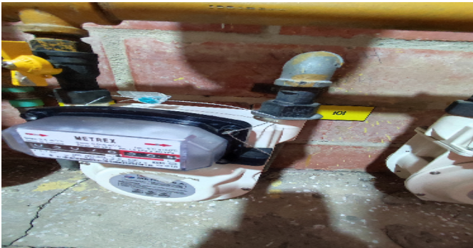
Contador de Gas
