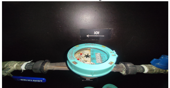
Contador de Agua
