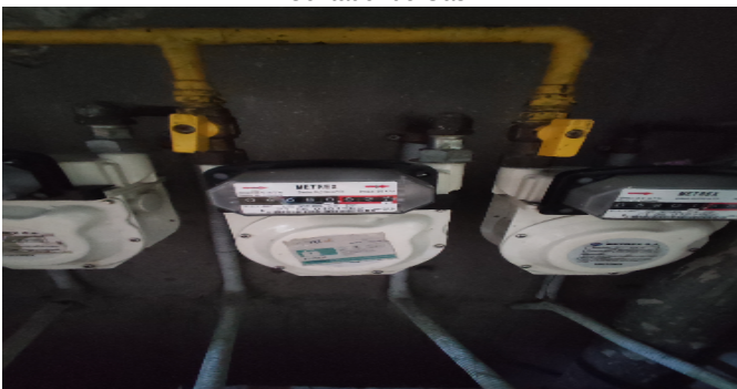
Contador de Gas
