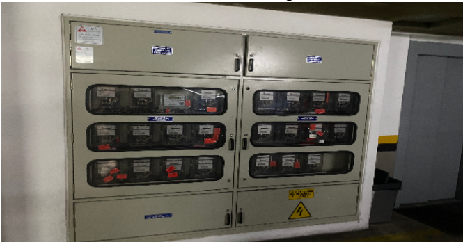
Contador de Energia
