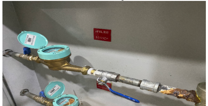
Contador de Agua
