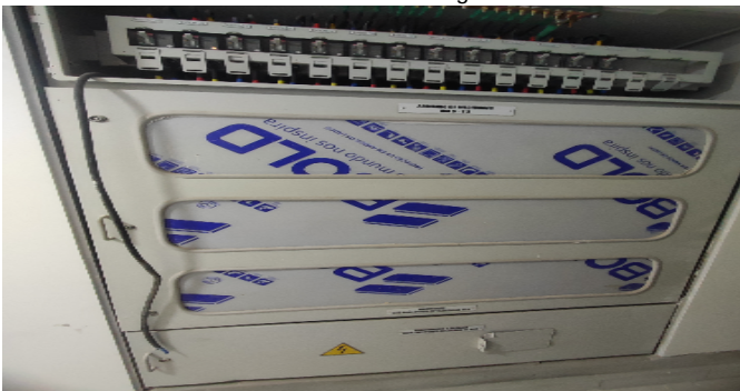
Contador de Energia
