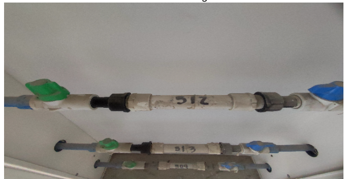
Contador de Agua
