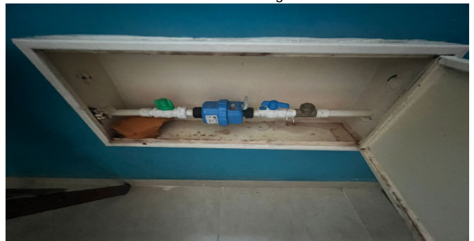
Contador de Agua
