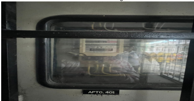
Contador de Energia
