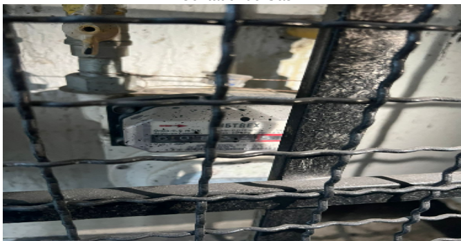
Contador de Gas
