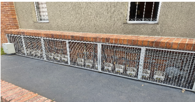
Contador de Gas
