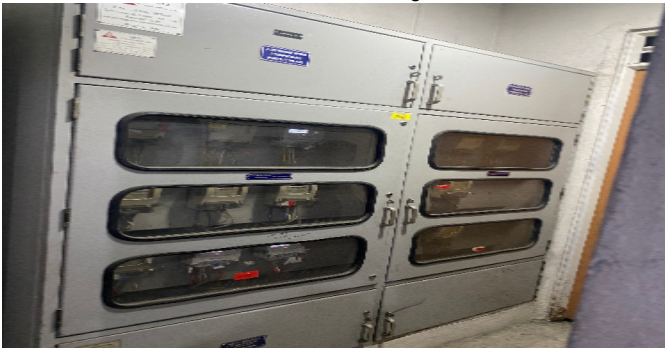
Contador de Energia
