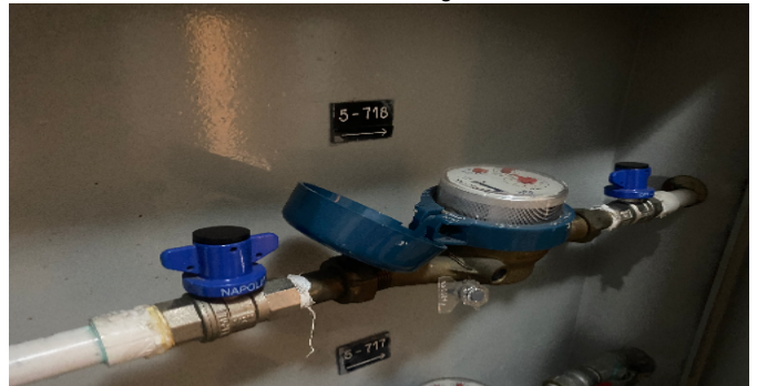
Contador de Agua
