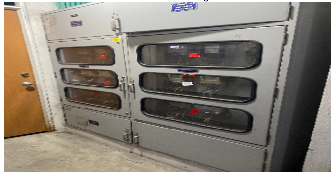
Contador de Energia
