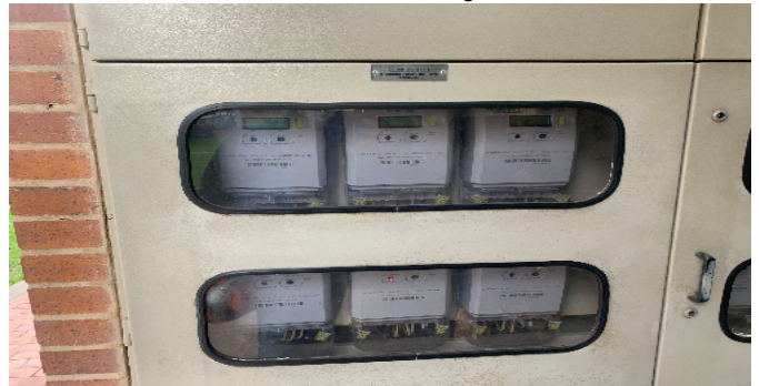
Contador de Energia
