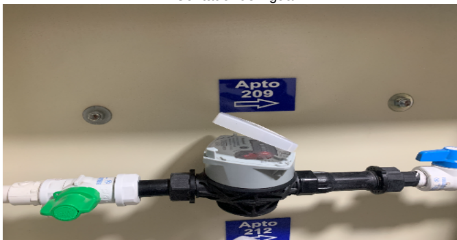
Contador de Agua
