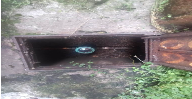
Contador de Agua
