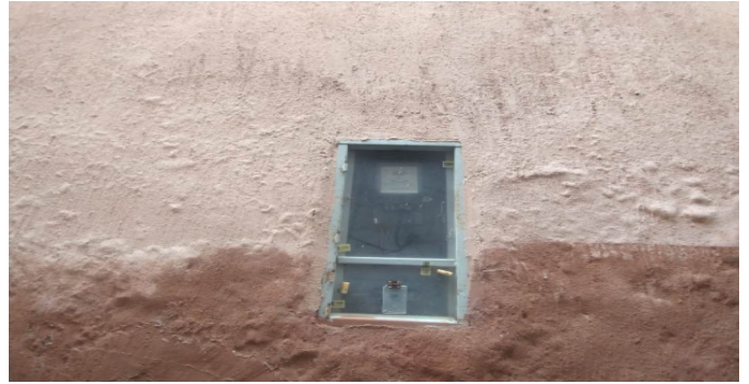
Contador de Energia
