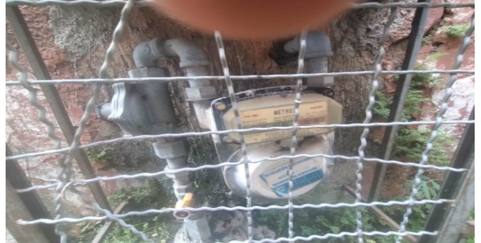
Contador de Gas
